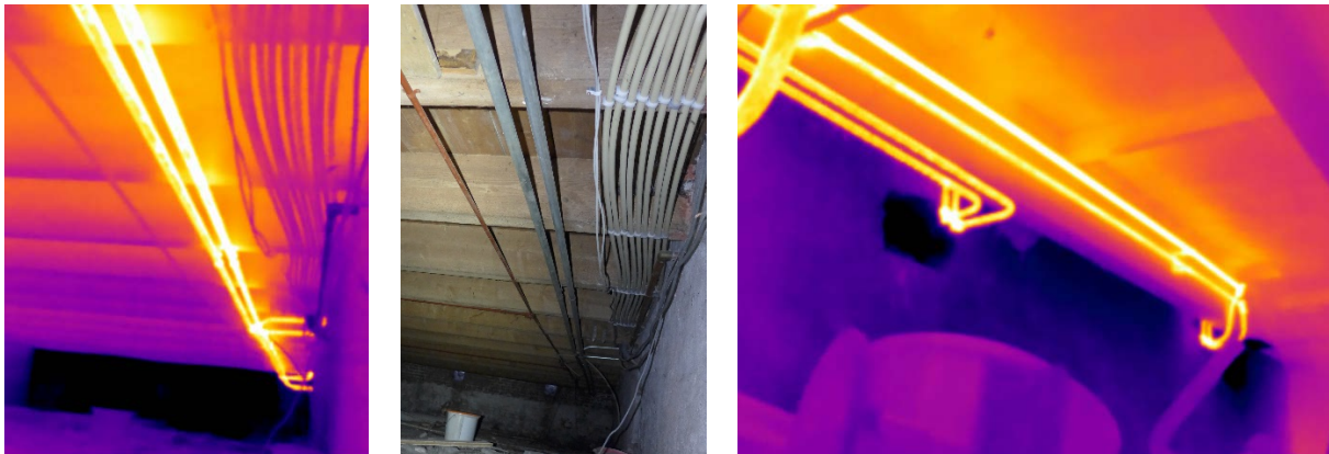
Energieverlies via ongeïsoleerde CV-leidingen in een kruipruimte. Links, het warmtebeeld van de hoofdverdeelleidingen, rechts de leidingen naar de radiatoren op de beganegrond. Nodeloze verliespost, snel te verhelpen door goede leidingisolatie. © ejn.
