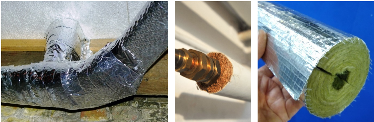
Door toepassing van warmtestraling reflecterende leidingisolatie zullen de leidingverliezen in de kruipruimte tot een minimum beperkt kunnen worden. Gezorgd moet worden dat consequent alle leidingdelen en appendages een minstens 4cm. dikke 'jas' krijgen met hoogglanzende aluminium ommanteling om energieverlies via alle thermische overdrachtsmechanismen – straling, geleiding, stroming – te blokkeren. De middelste foto toont een oude houtwol-gipsmantel leidingisolatie; standaardadvies is om die te vervangen door moderne mantelisolatie die bij dezelfde afmetingen 3x zo effectief is. © ejn
